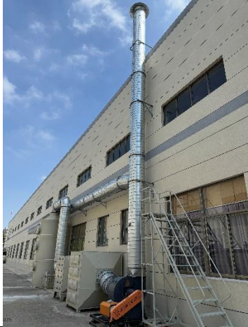
废气处理装置
